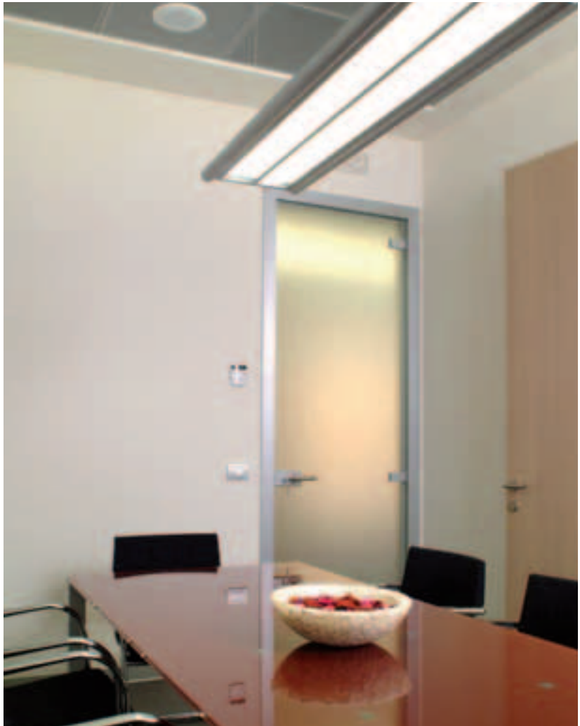
■ La sala riunioni è dotata di dispositivi di comando a infrarossi interfacciati con il sistema in tecnica bus.
